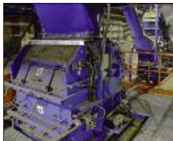
Impianto di raffinazione dei digestati
